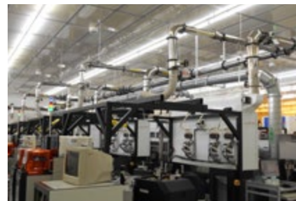
废气收集管道
