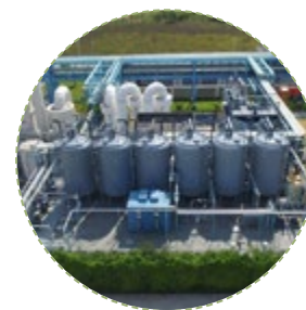
废水回用处理设施
